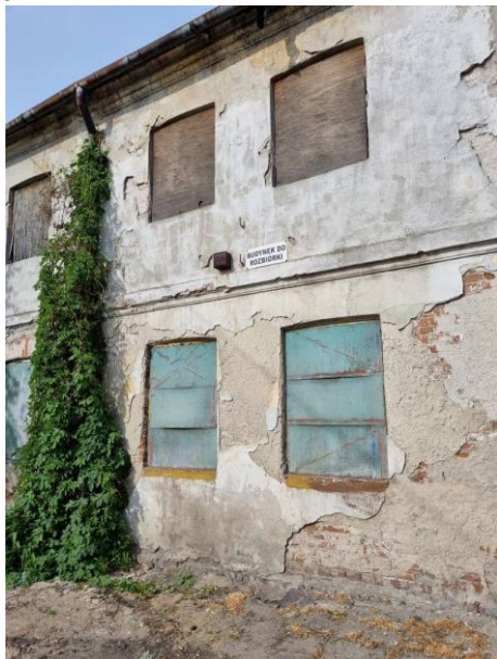
Fotografia 34. Budynek przeznaczony do rozbioru
